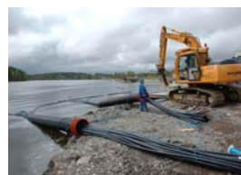
Järvilämpöpumppu 290 kW , 7,5 km putkea Keiteleessä
